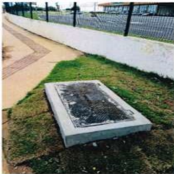
CAIXA DE PASSAGEM – CAMPO GRANDE / MS.
